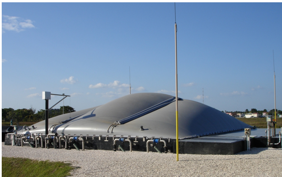
BIOLAK ® GAS Liquid-Anlage für Getränkeproduktion 1.200 m 3 /d, 2.450 kg CSB/d
